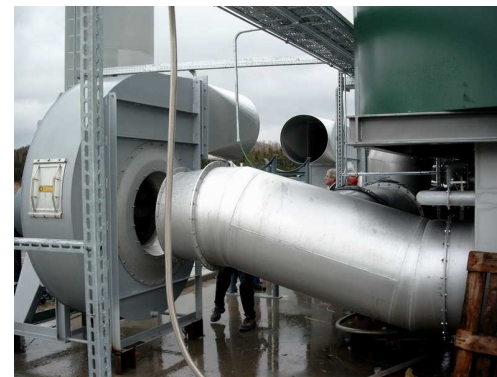
Montage RTO - Anlage
